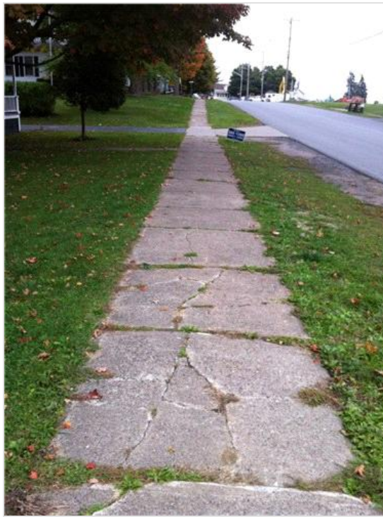
REC uneven sidewalk
